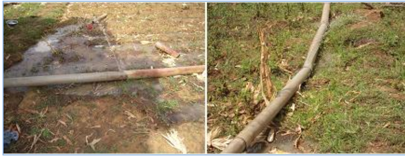
Figure 8: Fuites identifiées sur le réseau de Talembika
